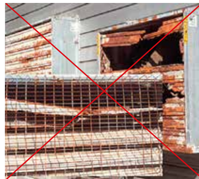
Фото 1. Сгнившие от ржавчины жалюзи торцевых вентиляторов – довольно частая картина на животноводческих предприятиях. BlueFan позволяет избежать этой проблемы
